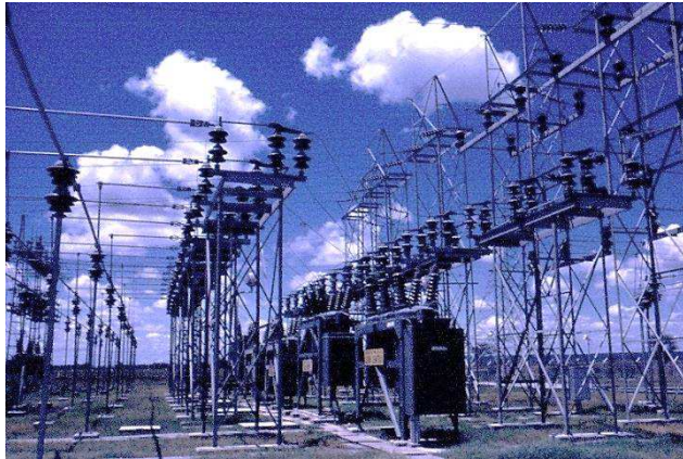
Foto SE-Maniobras 60 kV.
