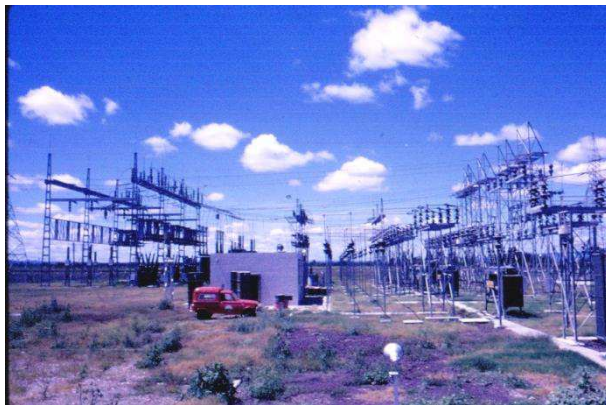
Foto de Subestación 161 KV a la izquierda, y la 60 KV a la derecha.
