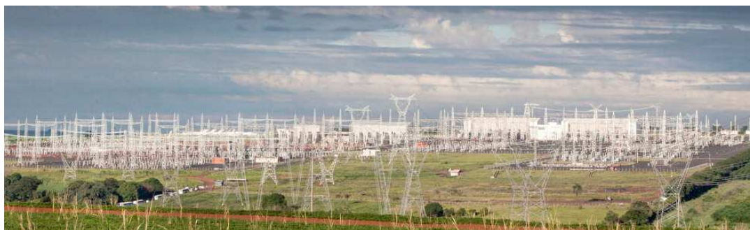
Vista de Subestación en Porto Velho
