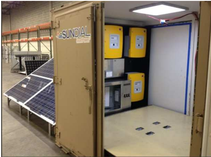
Planta solar portátil en prueba en la fábrica.
