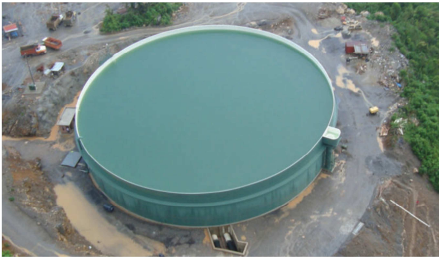
Tanque de almacenamiento y reposo con Planta Choloma, en Guatemala.
