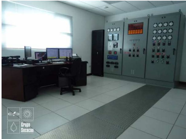
Cuarto de control de la Planta Choloma, Guatemala.
